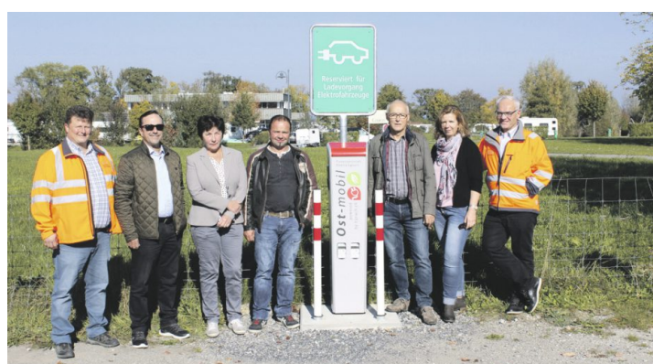
Vertreter der Gemeinde Egnach und der Elektra Egnach nehmen die Ladestation in Betrieb. Bild: PD
